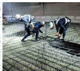
縦取り式ではコンクリート打設と鉄筋の組み立てを同時進行できる
